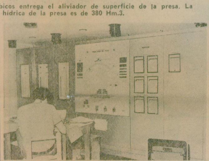
Casa de guardia, con tablero que permite conocer el funcionamiento de la presa, descargador de sólidos, el riego, etc., con un riguroso control técnico.
