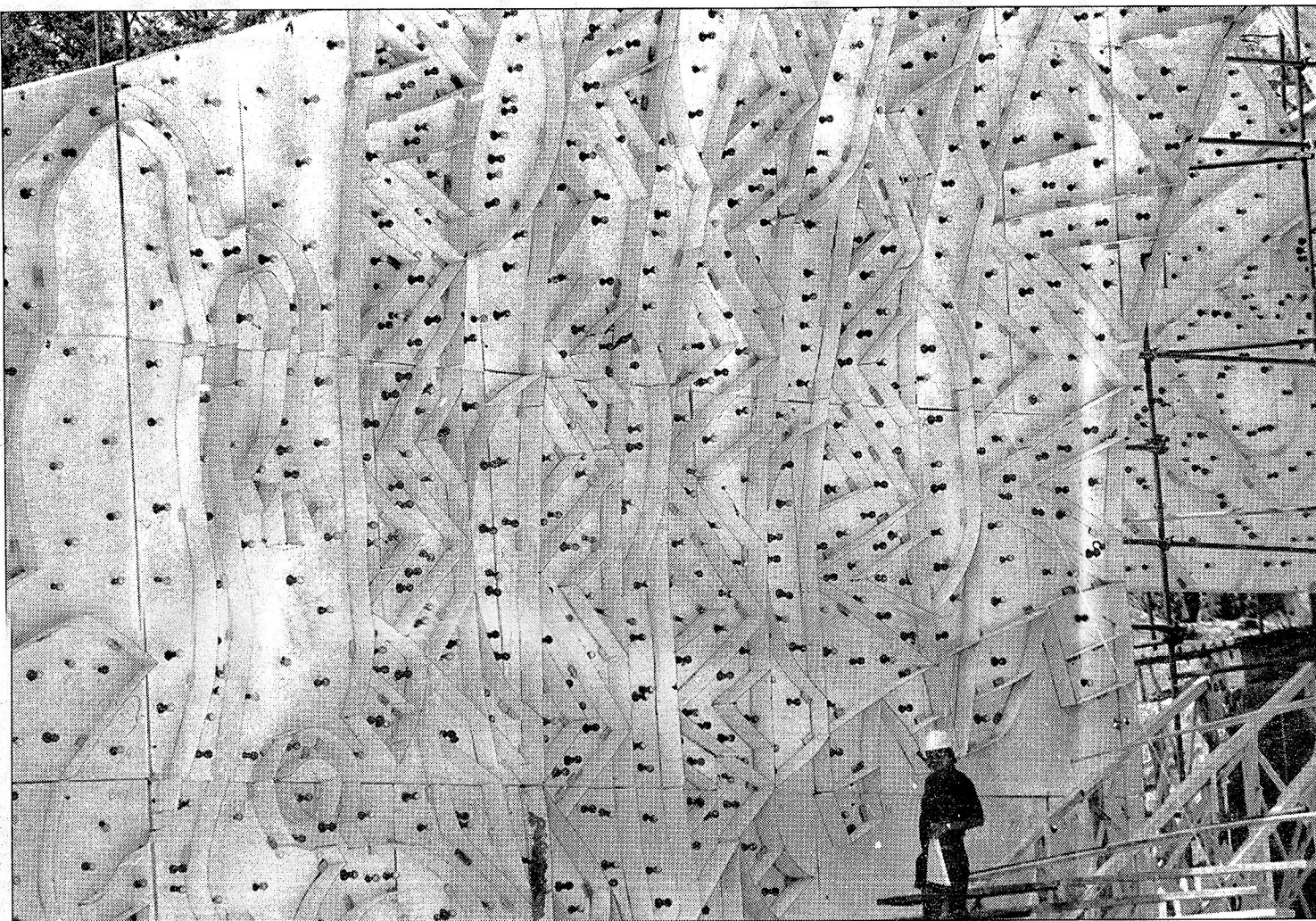
Un operario empujando un panel con cientos de focos.
