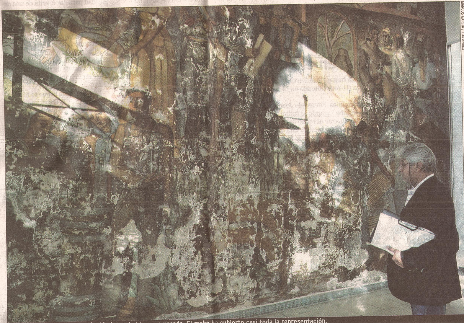
ARRUINADO. La humedad afectó al mural el invierno pasado. El moho ha cubierto casi toda la representación.
