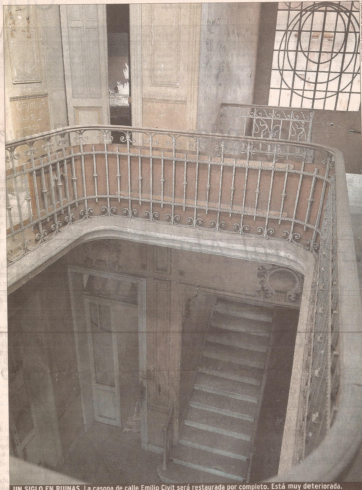
UN SIGLO EN RUINAS. La casona de calle Emilio Civit será restaurada por completo. Está muy deteriorada.
